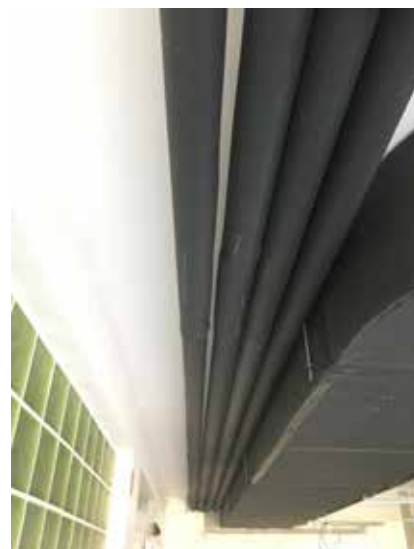
Cevi za povezavo ventilacijskih konvektorjev s toplotnimi črpalkami ter prezračevalni kanal.
