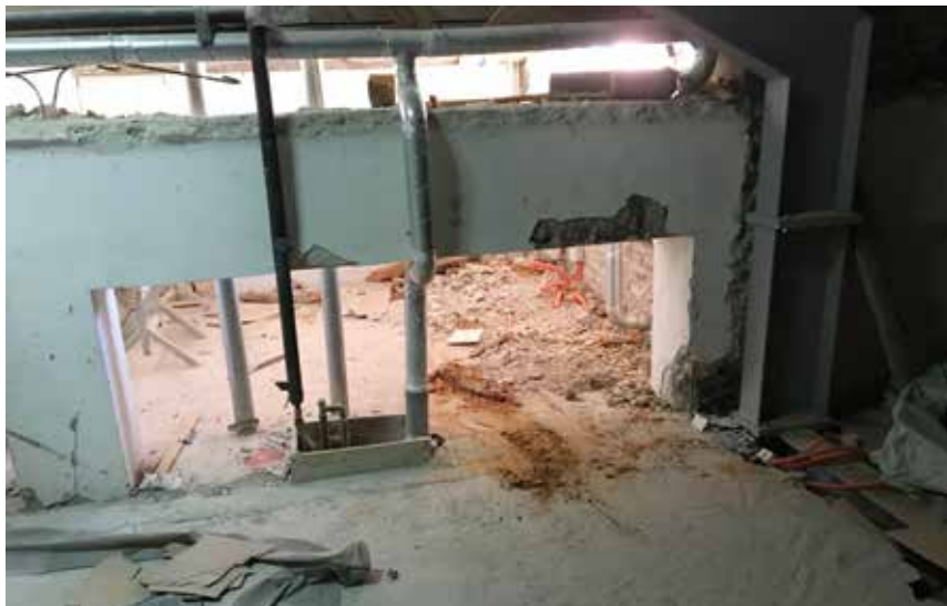
Nefunkcionalni deli sten za odstranitev na podstrešju.
